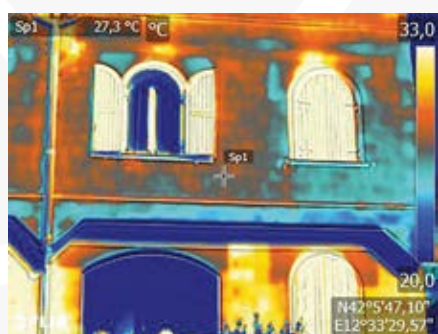
DISTACCO INTONACO NON VISIBILE
